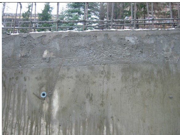
Figur 5.18 Frostskader fersk betong. (Foto: Norconsult AS)
