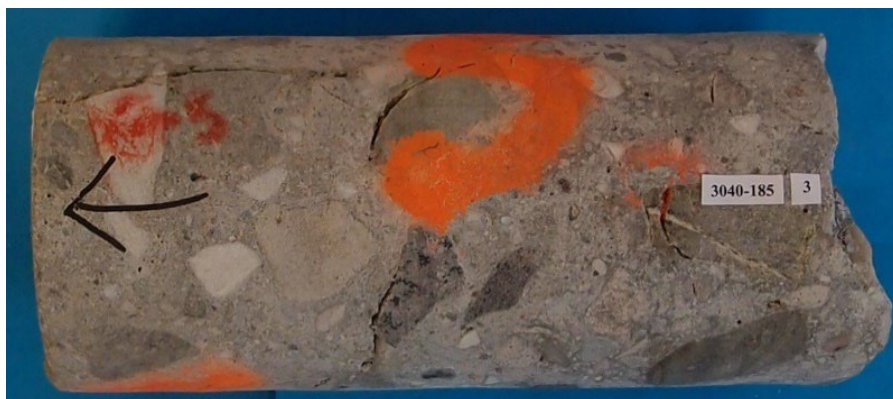
Figur 8.6 Oversiktsbilde av en borkjerne. Merk det tydelige risset som går inn fra overflaten samt «gap» i noen av kontaktsonene mellom tilslag og sementpasta. (Foto: SINTEF Community)
