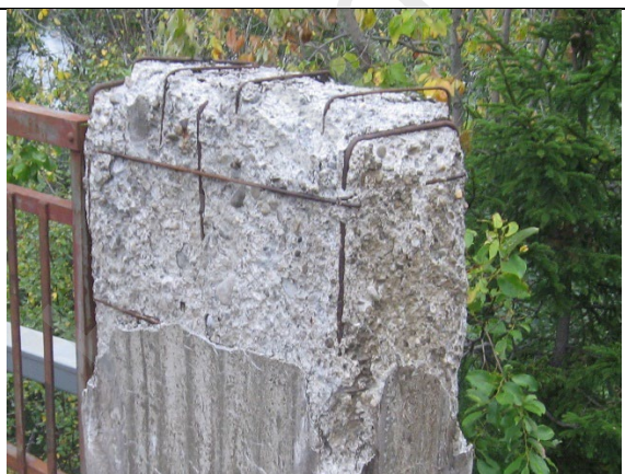
Figur 5.17 Frostskader herdet betong. (Foto: Norconsult AS)
