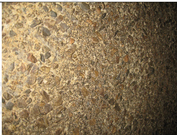
Figur 5.22 Erosjon. (Foto: Norconsult AS)
