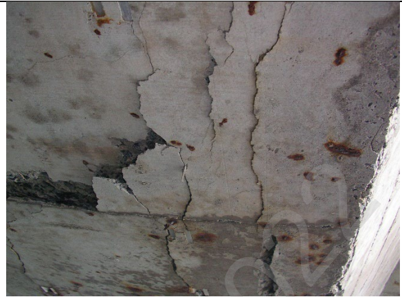
Figur 5.8 Rustsprengning. (Foto: Stærk & Co as)
